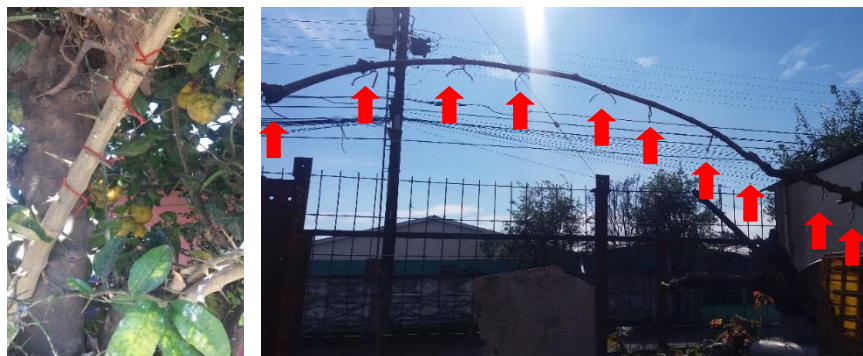
Figura 1. Instalación de emisores en grupo de 10.
